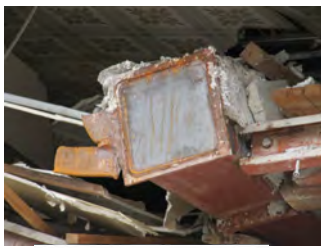
柱梁接合部のパネル溶接部の破断 (隅肉溶接?)
