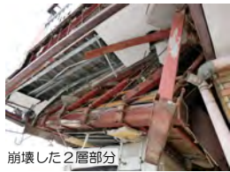
崩壊した2層部分
