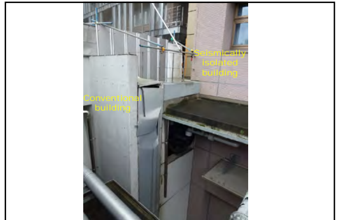
エキスパンションジョイントの被害
