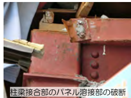
柱梁接合部のパネル溶接部の破断
