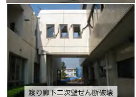
渡り廊下二次壁せん断破壊
