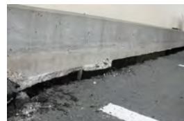
南側外付けフレーム脚部付近の地盤変状
